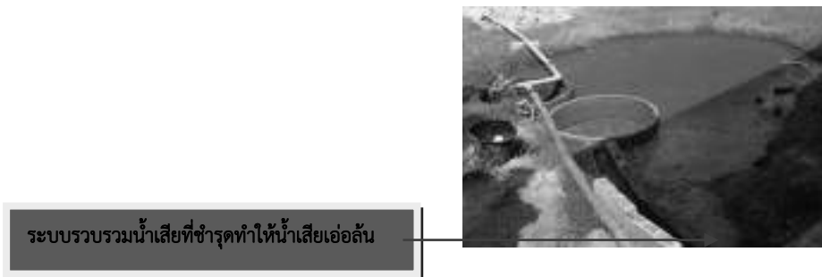
รูปที่ 7.2-4 ระบบรวบรวมน้ำเสีย ที่มีน้ำเสียเอ่อล้นออกนอกรางและบ่อรวบรวมน้ำเสีย
