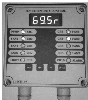
รูปที่ 8.1-4 อุปกรณ์ควบคุมอุณหภูมิภายในโรงเรือน
