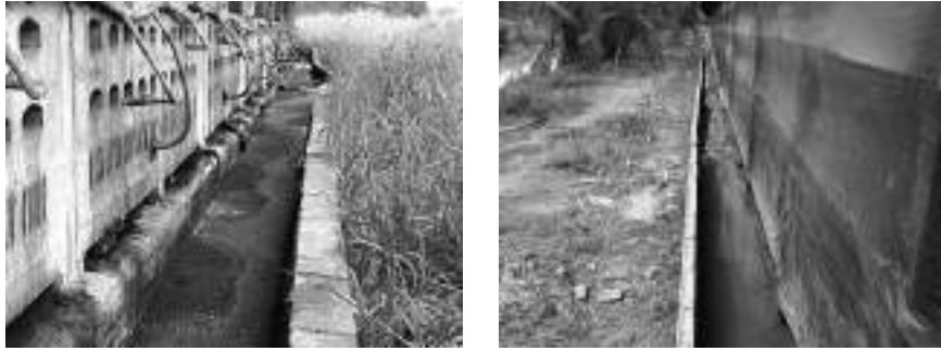
รูปที่ 6.4-7 ลักษณะรางระบายที่มีของเสียดกค้างและรางระบายน้ำที่ไม่มีของเสียดกค้าง
